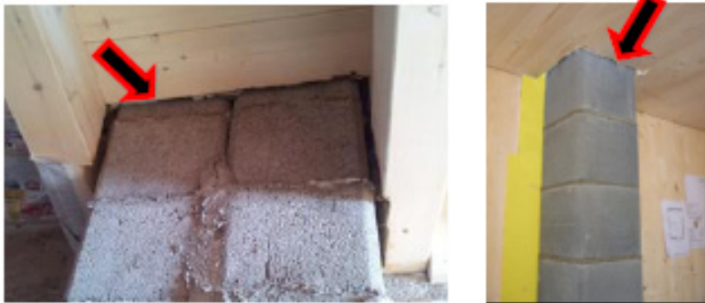
Esempi di camini previsti per combustibili solidi non eseguiti correttamente: ignorata completamente la distanza di sicurezza dai materiali combustibili
